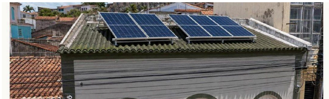
Sistema fotovoltaico do CEAPE Brasil: 31,15 kWp, 70 módulos de 445 W, no prédio da Rua Oswaldo Cruz, 1246, Centro de São Luís (MA). Em operação desde 2021.
